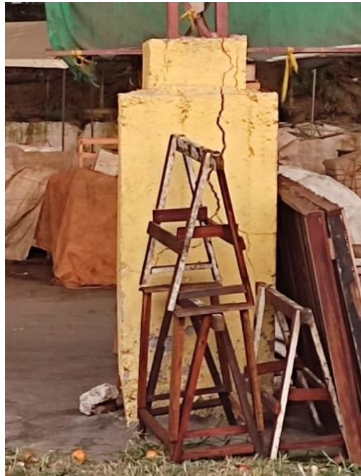
Figura 4 – Rachaduras nas colunas de sustentação da estrutura da feira livre do bairro Califórnia, Itabuna, 2023
