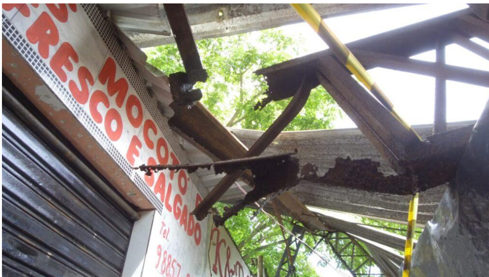
Figura 3 – Desabamento de parte da cobertura da feira livre do bairro Califórnia, Itabuna, 2023
