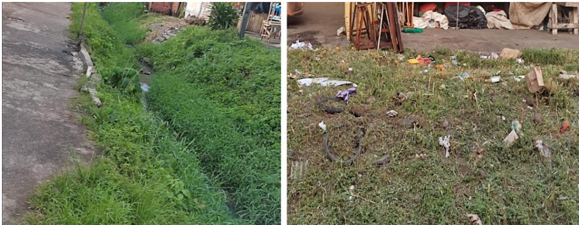
Figura 5 – Ervas daninhas e acúmulo de sedimentos e resíduos sólidos no canal de macrodrenagem na feira livre do bairro Califórnia, Itabuna, 2023
